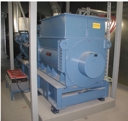
Abb. 9: Schwingungsisierte Aufstellung eines Stromaggregates, Gewicht ca. 7.100 kg, Maße ca. 4,6 m x 1,7 m x 2,5 m hoch, Drehzahl 1.500 Upm aufgestellt auf 8 Stück Feder-PHONOLATOREN Typ A8/89, Isolierfaktor 97%
